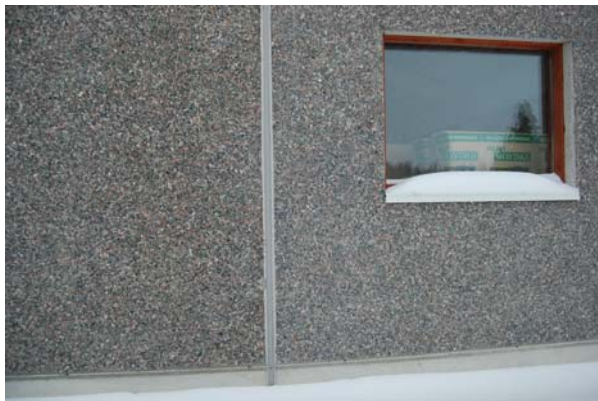
Sammenføyning av veggelementene. En estetisk fin fjøsvegg med små elvestein. For pristillegg Kunne en få betongkledning rundt vinduene, som sammen med vindussprosser gir et enda mer estetisk utseende.
